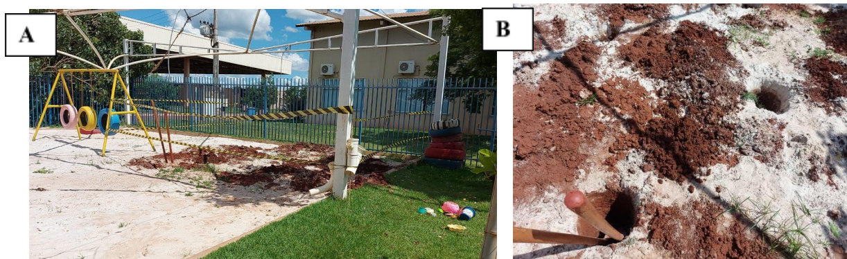
Figura 9 – (A) Vista do espaço da oca com as aberturas dos furos para a fundação. (B) Detalhe das aberturas para fixação dos pilares.
