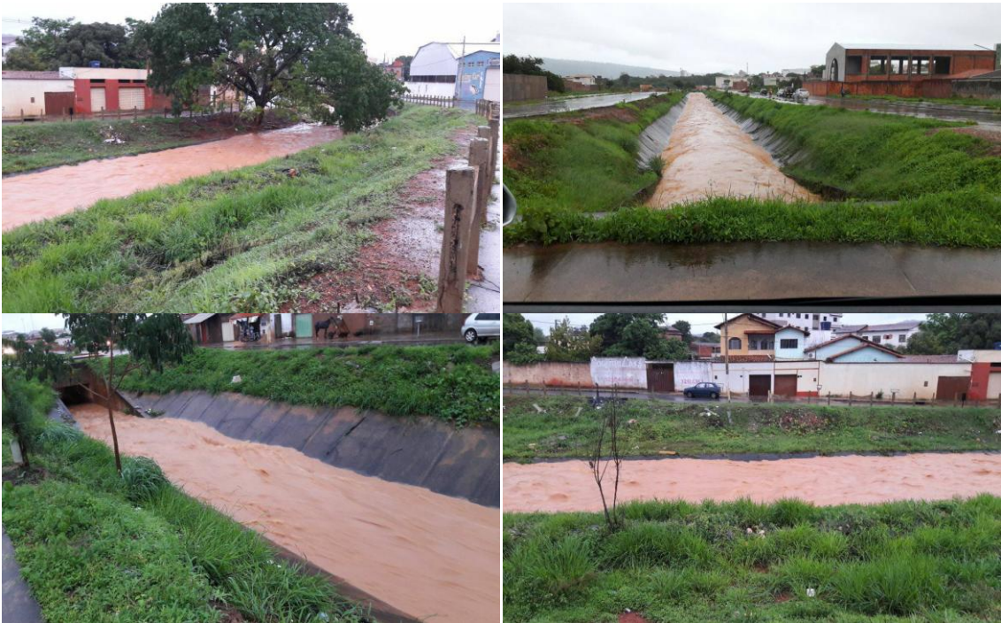
Figura 1 – Canal de escoamento da Avenida Vicente Guimarães, em Montes Claros (MG), após chuva ocorrida em 2017.
