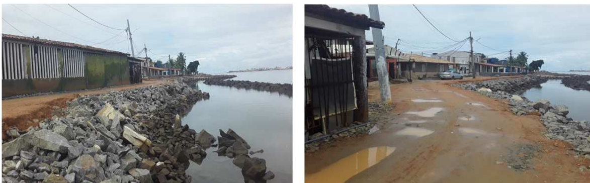
Figura 9 – Obras de contenção pouco eficientes às inundações em Atalaia Nova.
