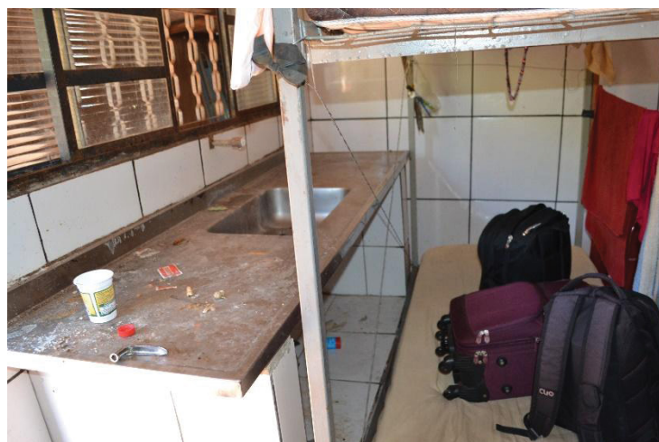
Figura 09-Alojamento em condições precárias em Indaiá do Aguapeí. Fonte: Pesquisa de Campo (2016-2019). Organização: Autores (2021).
