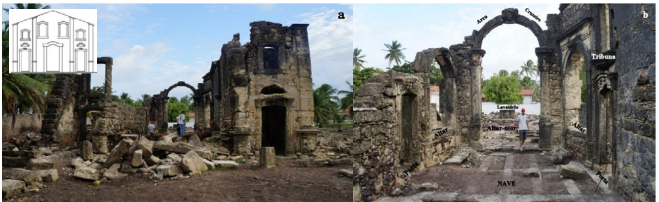
Figura 9 - Ruínas de Almagre. a) Vista da fachada frontal e, em detalhe, modelo da fachada completa. Nota-se que os cunhais da torre estão com risco de desabamento; b) Detalhe de alguns componentes internos da igreja. Fotos: Luciano Pereira.
