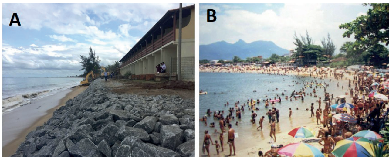
Figura 3: (A) Obra emergencial para a contenção do processo de erosão costeira na praia do Abricó. Foto de Agosto de 2018. (Fonte: Acervo LAGEF). (B) Praia da Tartaruga sem evidências do processo erosivo no ano de 1998. (Fonte: https://www.facebook.com/Sospriadatartaruga/ ).
